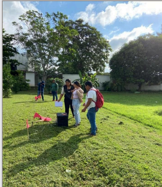
Figura 2. Colocación de electrodos dentro de la institución en área destinada para pruebas.
